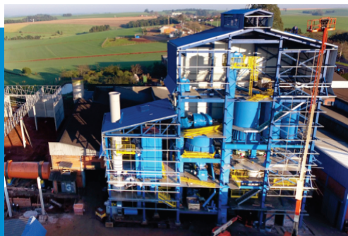
Preparação e Recuperação de Areia
