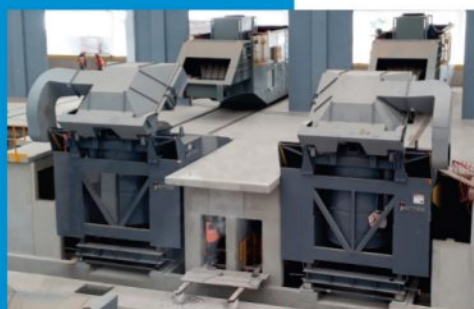
Carregamento de Forno com Exaustão
