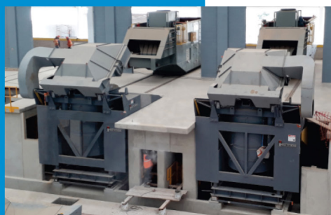
Carregamento de Forno com Exaustão
