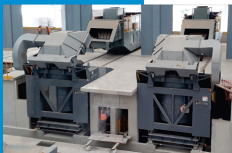
Carregamento de Forno com Exaustão
