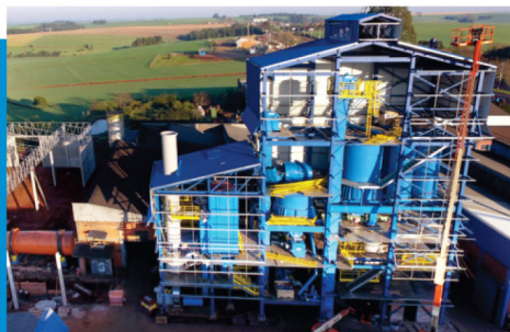
Preparação e Recuperação de Areia
