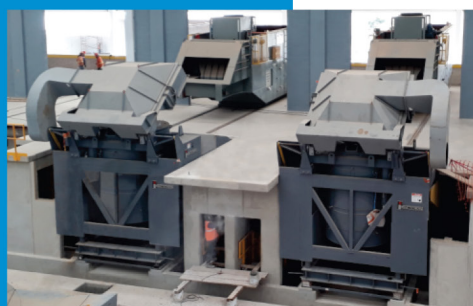
Carregamento de Forno com Exaustão
