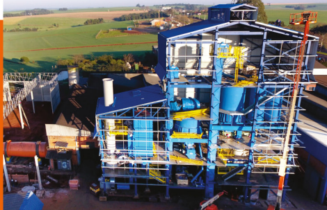
Preparação e Recuperação de Areia
