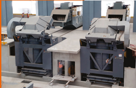
Carregamento de Forno com Exaustão
