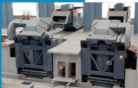
Carregamento de Forno com Exaustão
